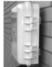
باکس نصب شده روی دیوار
